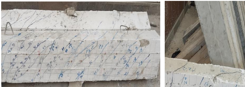
الشكل (17): شكل وتوزع الشقوق في الجائز R0.
