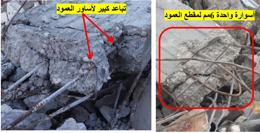
تابع الشكل(13): استخدام أسوار واحدة في المقطع العرضي وعدم وجود عكفات نظامية في أعمدة وجوائز من مبنى سكني منهار - جبلة
