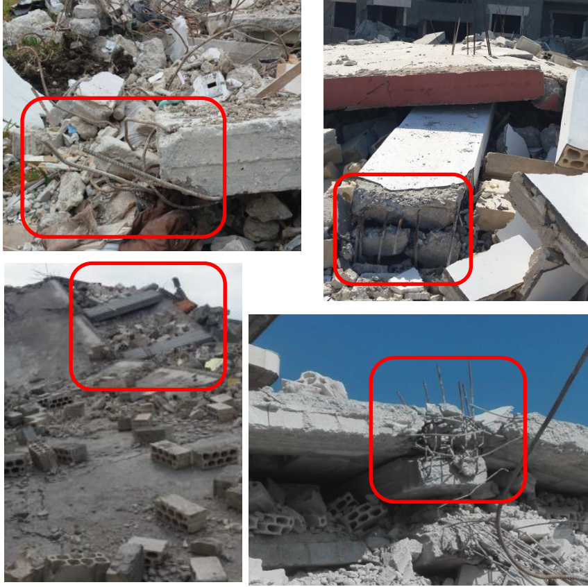
الشكل(14): نقص أطوال الإرساء للأعمدة عما يتطلبه الكود السوري- مبنى سكني منهار- جبلة
