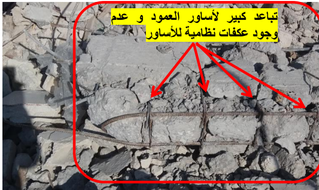
الشكل(12): تباعد كبير للأساور في أعمدة مبنى سكني منهار - جبلة
