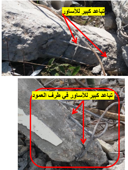
تابع الشكل(12): تباعد كبير للأساور في أعمدة مبنى سكني منهار - جبلة
