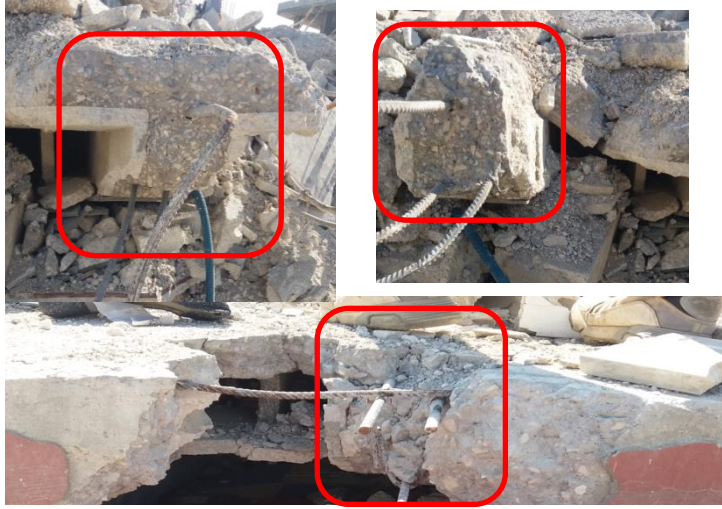
الشكل(15): تنفيذ التسليح العلوي للعصب بحيث يكون ضمن ارتفاع البلوكة- مبنى سكني منهار - جبلة
