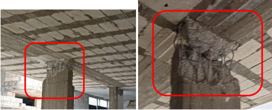
الشكل(9): تحطم منطقة المفصل اللدن أعلى أعمدة الطابق الأرضي-جيلة
