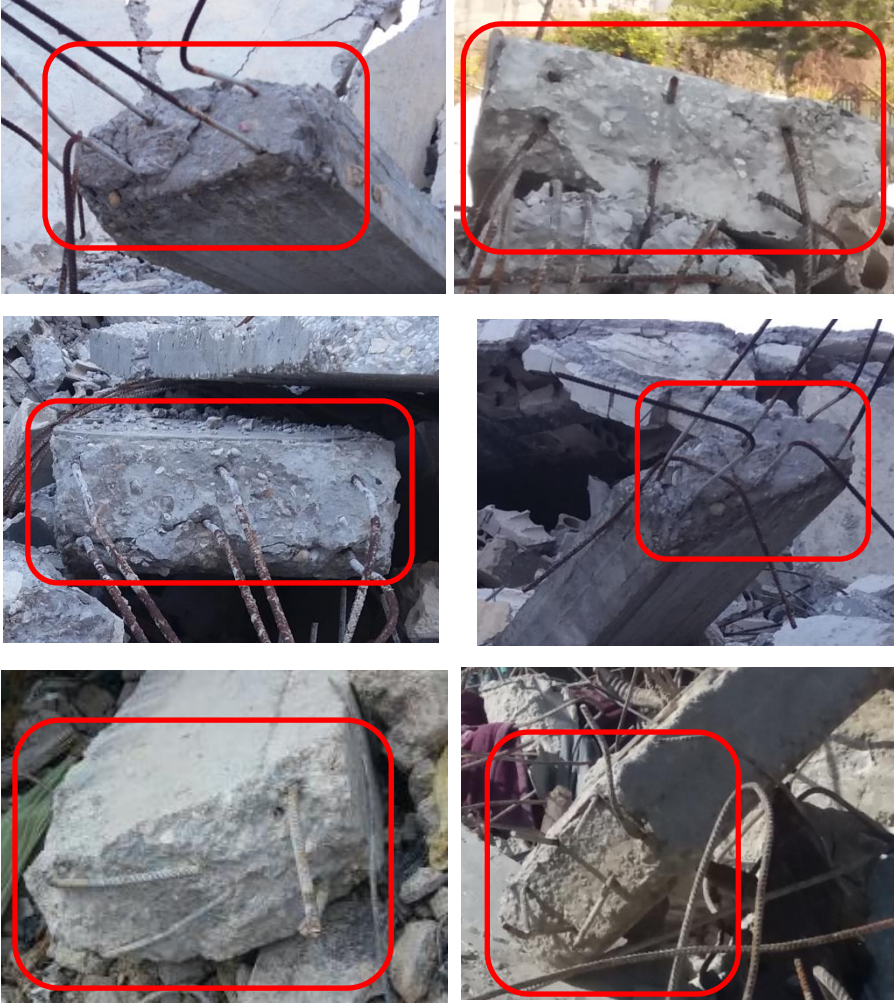
الشكل(10): قلة التسليح الطولي والعرضي في أعمدة مبنى سكني منهار - جبلة
