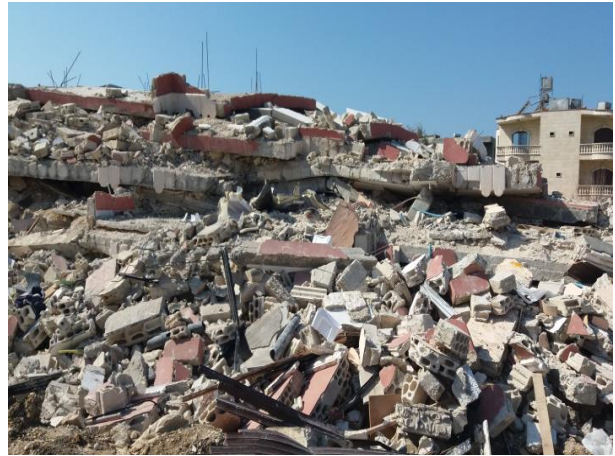
الشكل(25): انهيار هش لبناء سكني - جبلة
