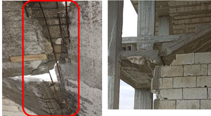
الشكل(16): عدم تنفيذ التسليح الطولي لشاحط الدرج بشكل صحيح
