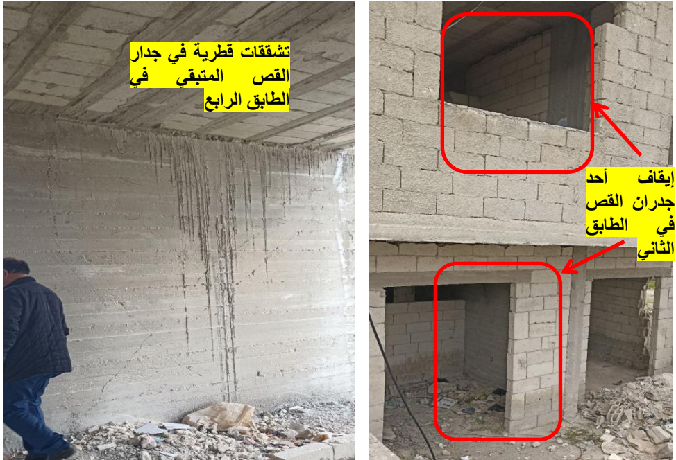
الشكل (17): إلغاء جدران القص بدءاً من الطابق الثاني في مبنى سكني - جبلة
