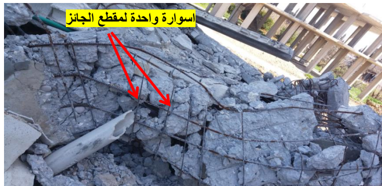
الشكل (13): استخدام أسوارة واحدة في المقطع العرضي وعدم وجود عكفات نظامية في أعمدة وجوائز من مبنى سكني منهار - جبلة
