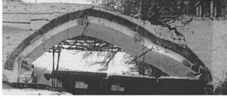
انهيار جسر بريستود نتيجة حمل مركز في ربع مجازة وفقاً ل [13] Cavicchi A, Gambarotta . (2005)
