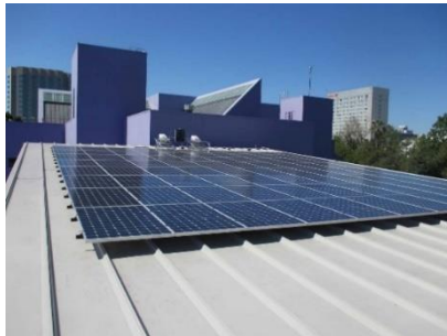
شكل (11) ألواح الطاقة الشمسية على سطح مبنى البناء
